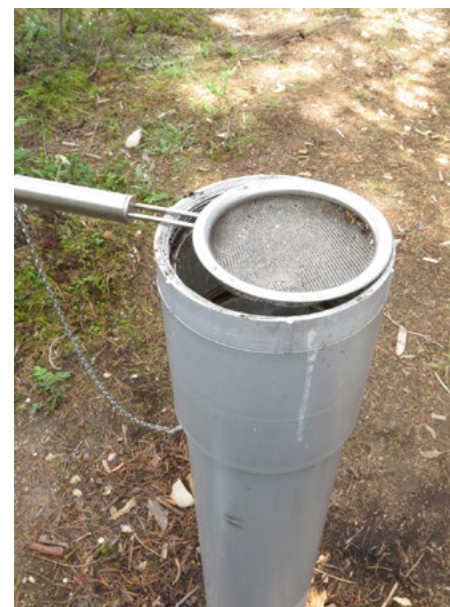
Tuyaux d'élimination des eaux grises
